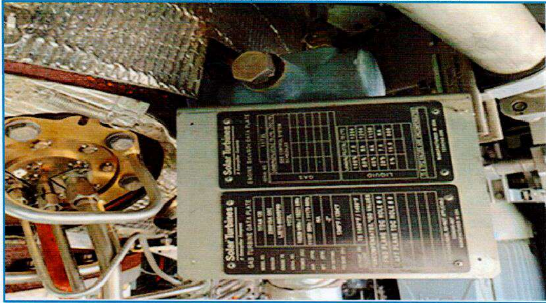
Ilustración 11-3. Datos de placa de la Turbina PGM Titan 130
